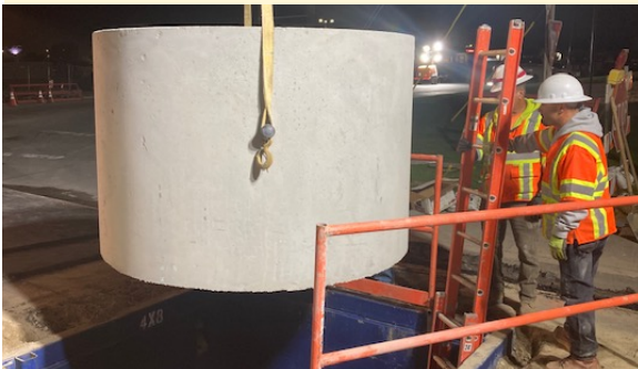
Las cuadrillas bajando un cilindro de hormigón para reforzar el pozo de registro.
