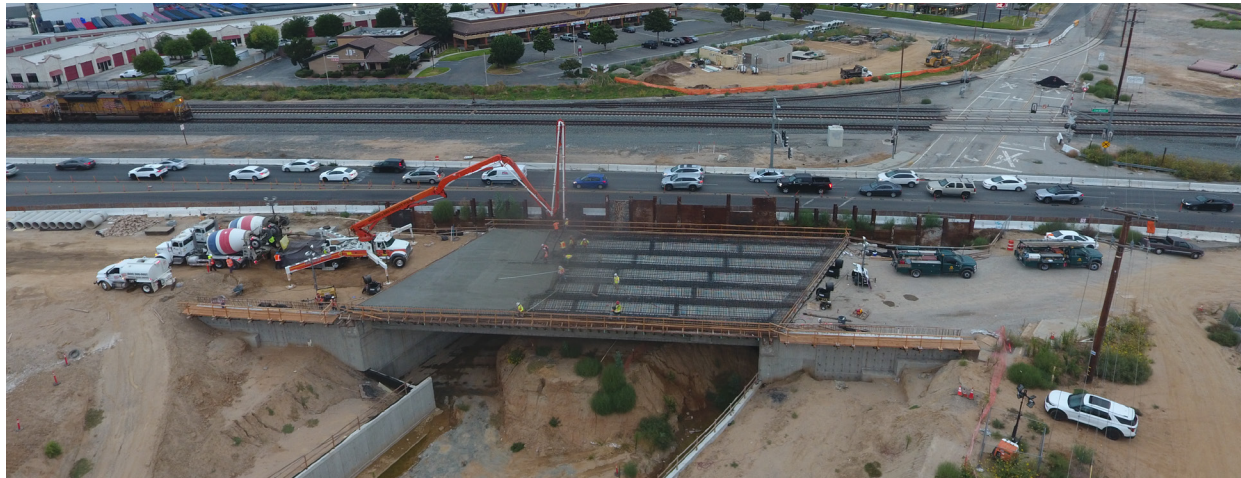
Avances del proyecto: Las cuadrillas colocando concreto en la plataforma del puente Van Buren Boulevard.
